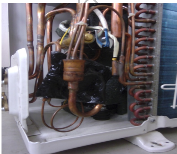
รูปที่ 3.2 เครื่องปรับอากาศก่อนการติดตั้งชุดแลกเปลี่ยนความร้อนแบบแผ่นเชื่อมติด
