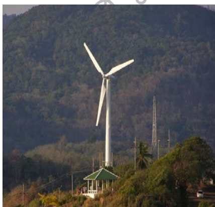
ภาพที่ 2.38 กังหันลมผลิตไฟฟ้าขนาด 150 kW ของการไฟฟ้าฝ่ายผลิตแห่งประเทศไทย ติดตั้ง ณ.แหลมพรหมเทพ จ.ภูเก็ต
