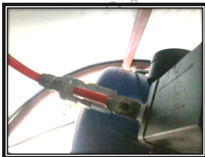
รูปที่ ค.6 การเปิดวาล์วลม
