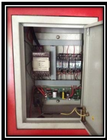
รูปที่ 3.13 การตู้วงจรระบบไฟฟ้าควบคุมนิวเมติกส์
