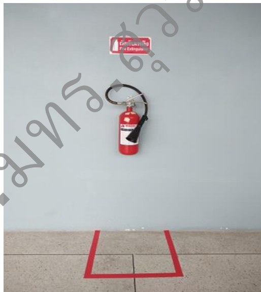
ภาพที่ 4.18 การวางถังดับเพลิง
